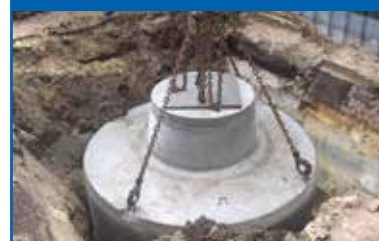
Regenwatersysteem woonhuis Epen
